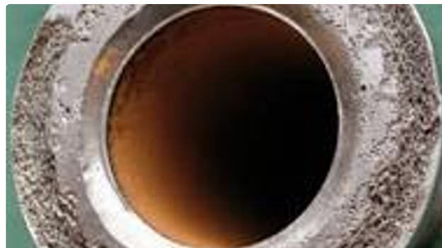
Corrosión por picadura ( pitting )
